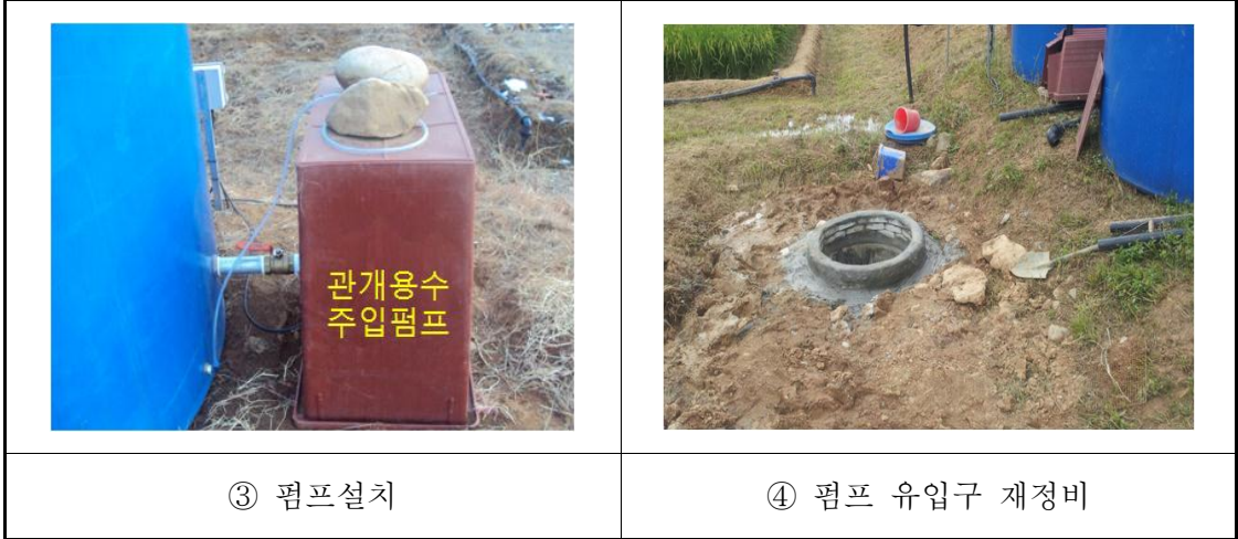
<그림 3-3-2> 수도시설 설치 및 재정비
